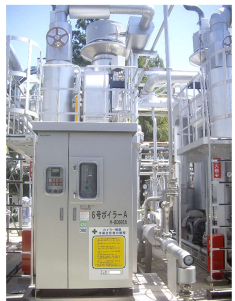
貫流ボイラ設備(6号ボイラ)
